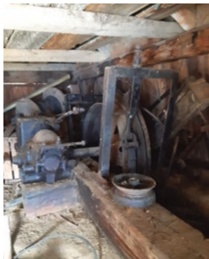
Maschinenantrieb Materialseilbahn Larcherberg
